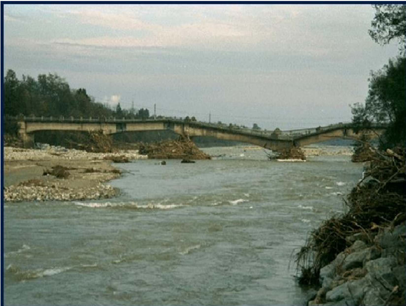
Torrente Orco. Vista da monte del ponte gravemente danneggiato per cedimento di una pila di sostegno.
